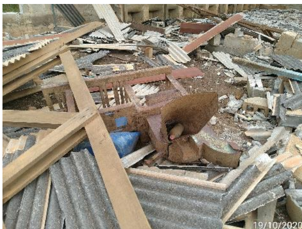
Foto 3 – Na Casa 17 foi identificado material de amianto, que exige segregação e destinação específica. 19/10/2020.
