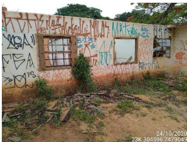
Foto 9 – Detalhe da Casa 28, Lote 31, onde foi identificado material de amianto. 24/10/2020.
