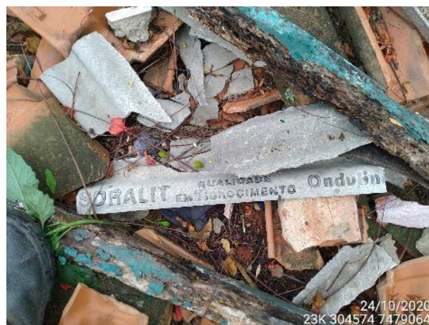
Foto 10 – Detalhe do material de amianto na Casa 28, Lote 31. 24/10/2020.
